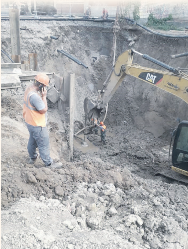
Огромный провал на улице Игнатова сейчас заделывают.
