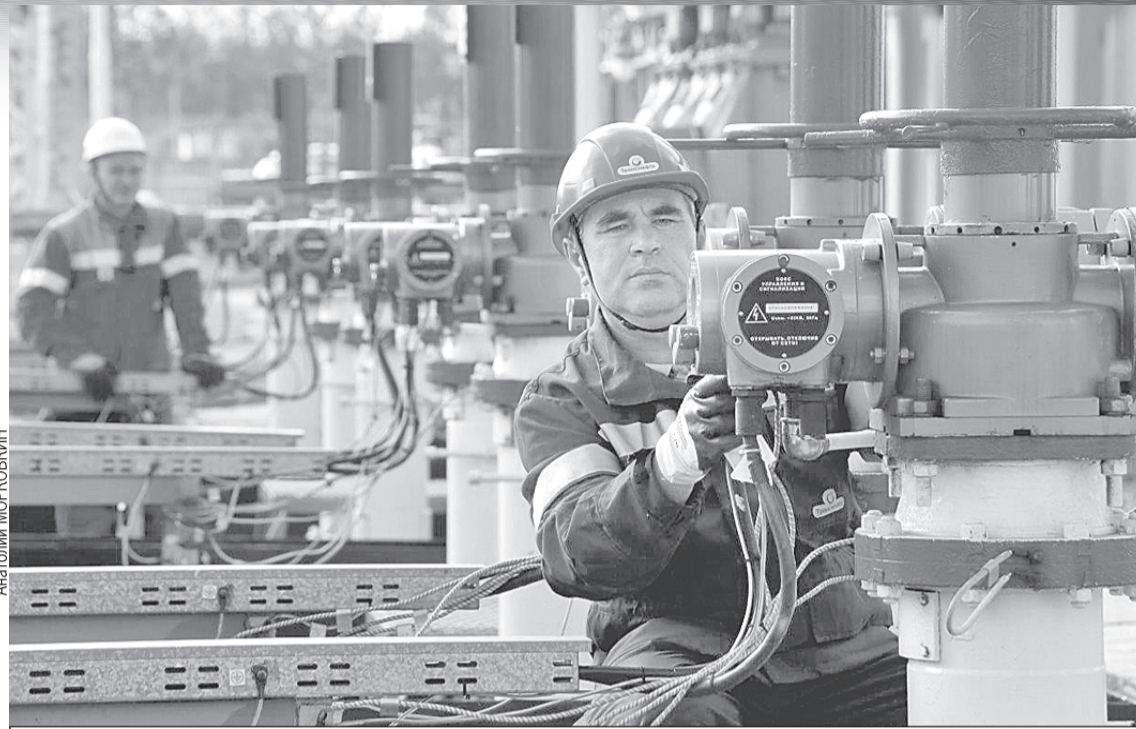
Проверка технологического оборудования на НПС «Сокур». Новосибирское РНУ, АО «Транснефть - Западная Сибирь».
