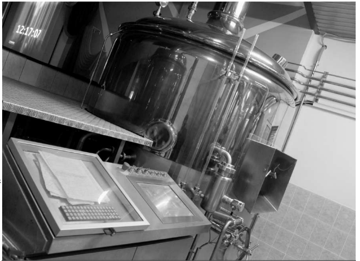
Так выглядит оборудование на пивоварнях с полной автоматизацией.
