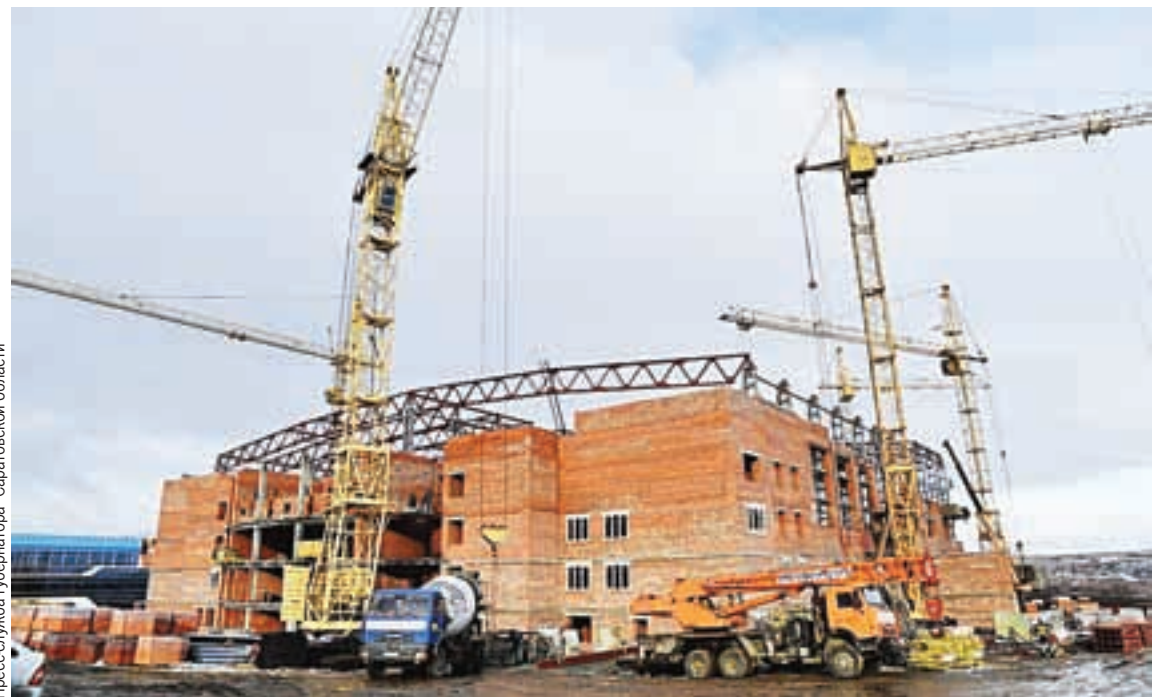
Строительство Дворца водных видов спорта в Саратове должно быть завершено до конца 2020 года.
