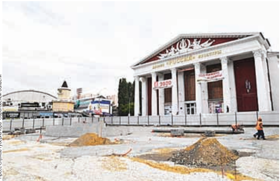
Еще недавно площадь перед ДК «Россия» была занята торговыми палатками. Теперь здесь будет современная зона отдыха.
