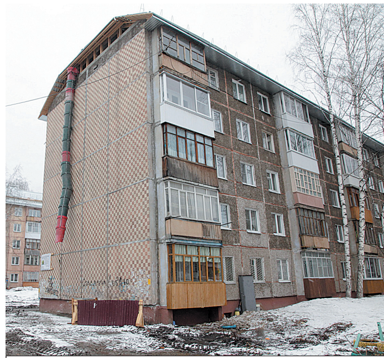
Плоские кровли в пятиэтажках, прежде протекавшие и промерзавшие, строители заменяют на новые скатные.
