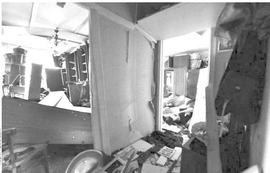
Между двумя квартирами снесло стену.
