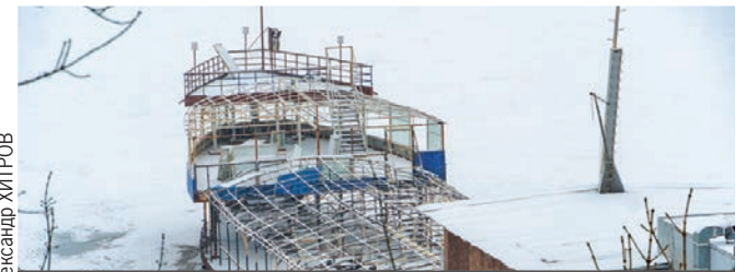
Пирс в виде баржи построили к 125-летию Владивостока, так что реконструкция давно назрела.
