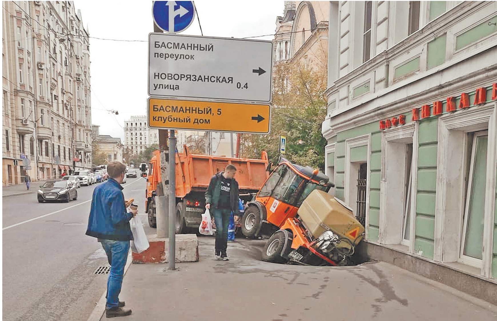
В центре Москвы на Новой Басманной улице вчера провалился асфальт. Провал площадью примерно 1 квадратный метр произошел на тротуаре, когда по нему ехала небольшая уборочная машина. Судя по всему, покрытие не выдержало тяжести спецтехники. В пресс-службе префектуры Центрального административного округа столицы «РГ» рассказали, что причиной провала могло стать подтопление грунта в результате дождей. Коммунальные службы вытащили застрявшую машину и приступили к ремонту аварийного участка тротуара.
