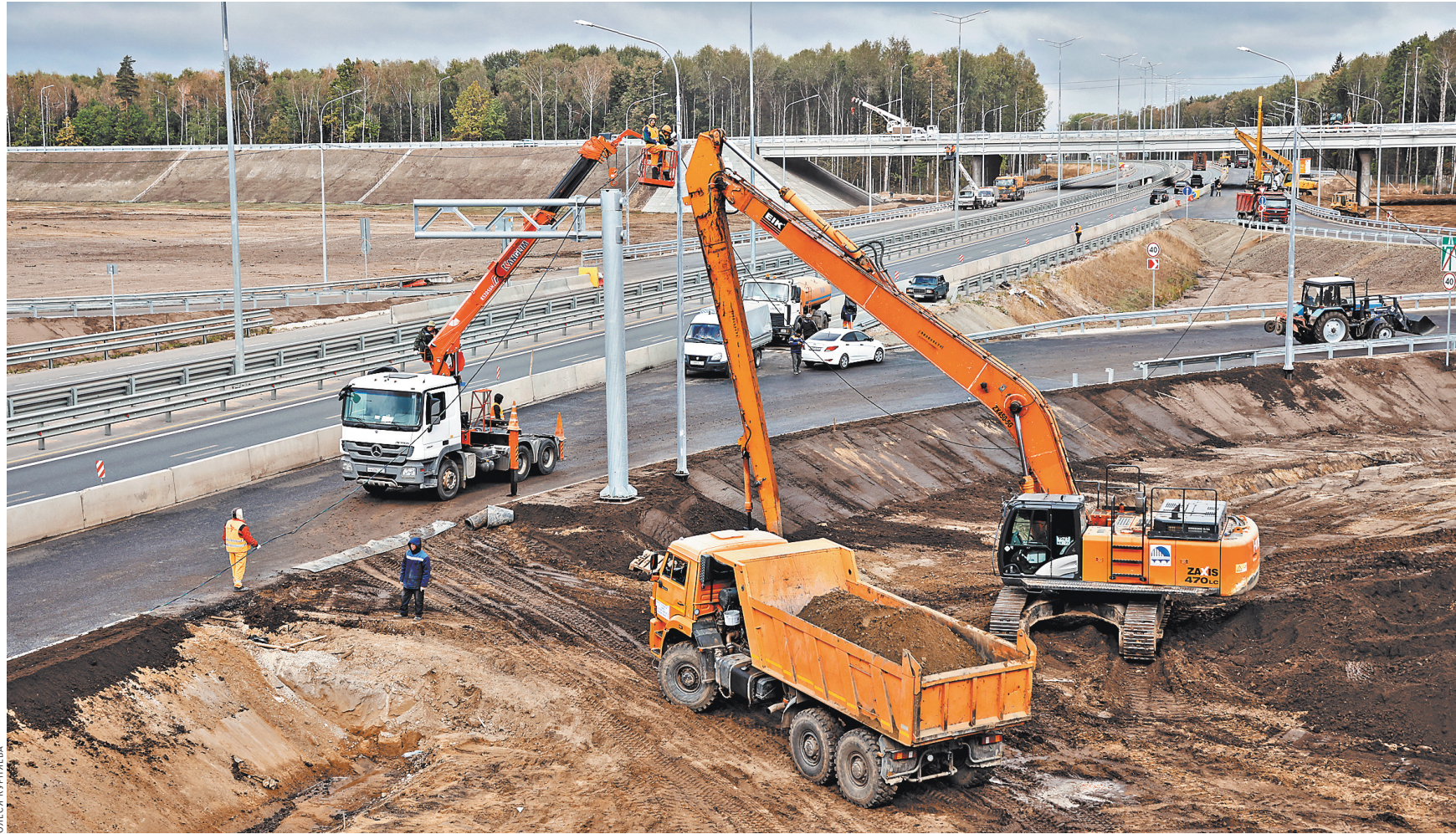
На первом отрезке возвели 11 искусственных сооружений, в том числе мосты, две транспортные развязки. На строительство участка ушло около миллиона кубометров песка и щебня.
