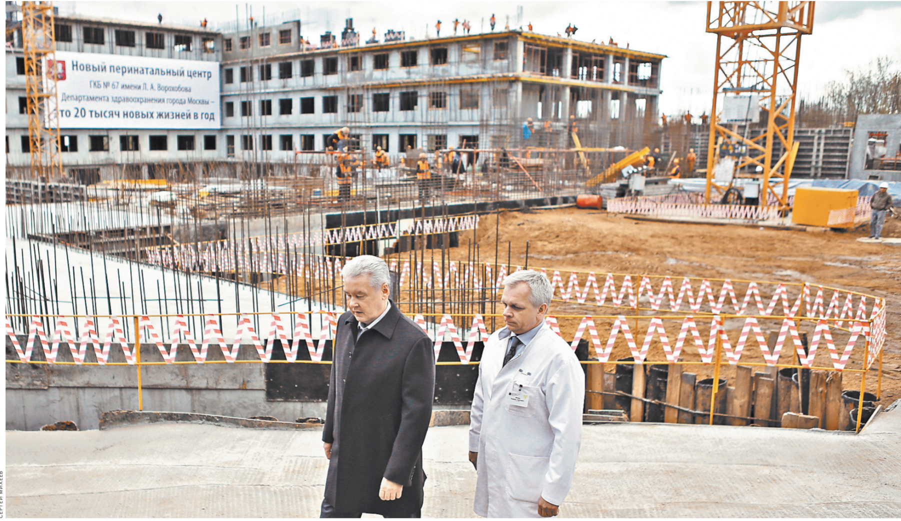
За пять месяцев возведено почти пять этажей перинатального центра. Сергей Собянин (слева) надеется, что полностью объект сдадут уже в следующем году.
